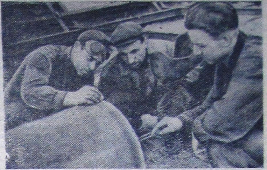
В БОЛЬШОМ коллективе рабочих монтажного участка треста «Центроэнергомонтаж» хорошо трудятся газорезчик Б. Казанцев, слесари С. Назаров и М. Ягупо. Они ежемесячное задание выполняют на 130—160 процентов. На снимке (слева направо): Б. Казанцев, С. Назаров и М. Ягупо за работой. Фото А. Тиховой.
