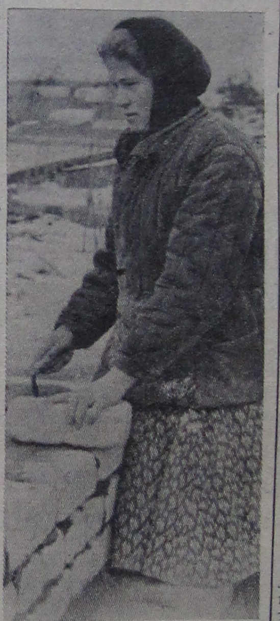
Встречая XXII съезд Коммунистической партии Советского Союза, строители левобережной стороны обязались к концу этого года подвести под крышу строящийся Дом культуры. Своё обязательство строители подкрепляют конкретными делами. Успешно трудится на стройке каменщик 5-го разряда Антонина Тимофеева. На снимке: А. Тимофеева за работой.
