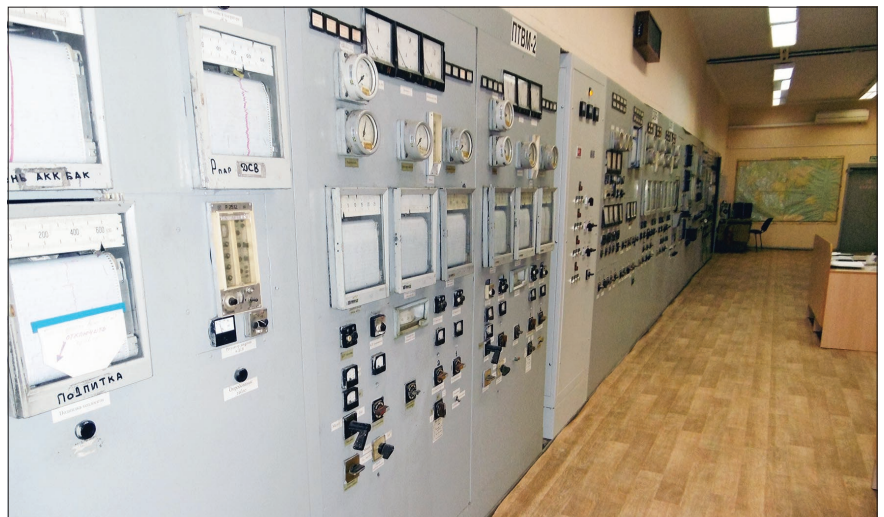
А так выглядел пульт управления Восточной котельной до модернизации.
